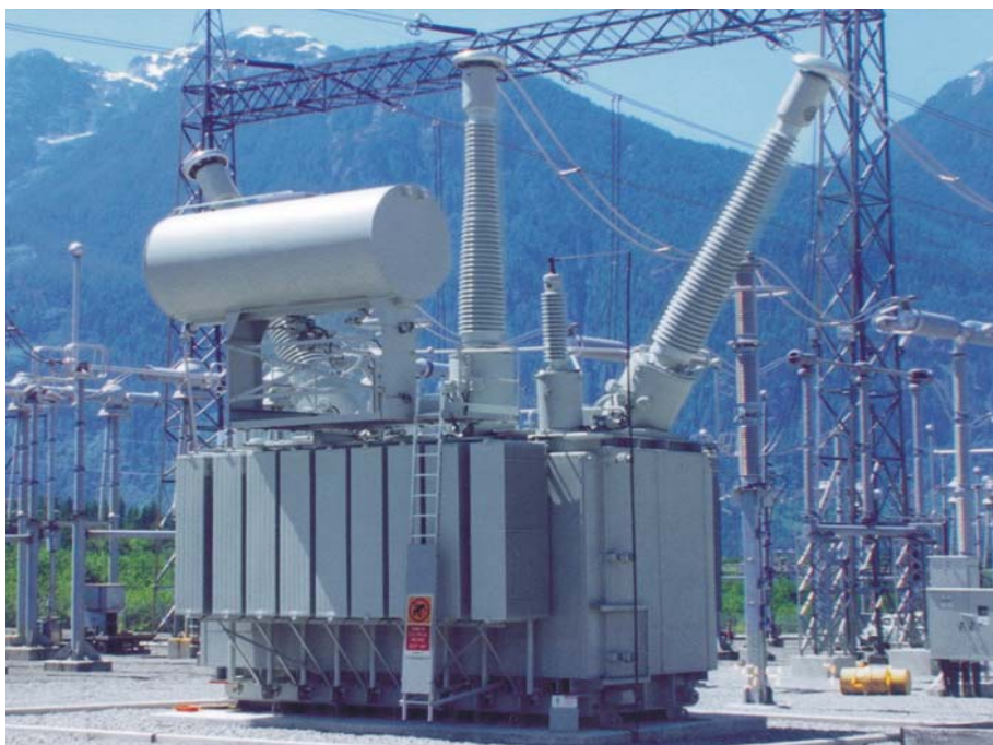
Bild 5.7. Blindleistungskompensations-Drosselspule 150 Mvar (Quelle: Siemens)
