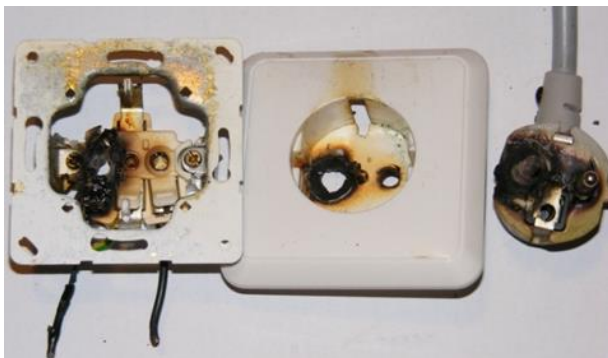
Abbildung 16: beschädigte Steckdose. An dieser Steckdose war eine Spülmaschine mit 3 kW Nennleistung etwa sechs Jahre lang problemlos betrieben worden. Wegen unangenehmen Geruchs beim Betrieb der Spülmaschine wurde schließlich der Handwerker gerufen.
